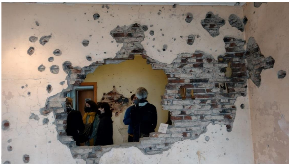
Figura 5. Agujero y marcas producidas durante el ataque, pared que separaba la habitación del comedor.
