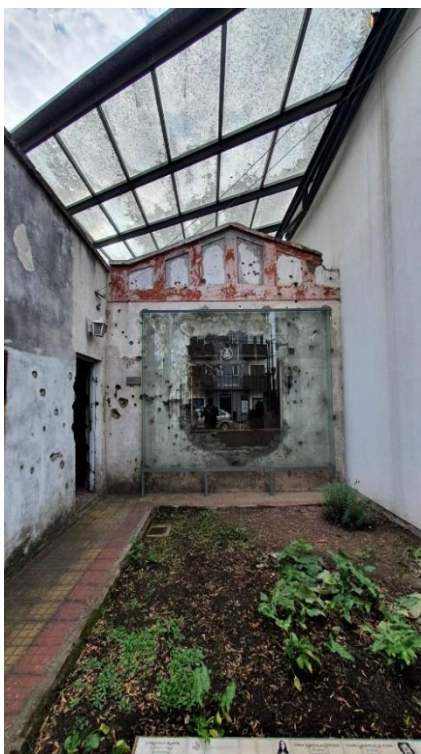
Figura 4. Agujero y marcas producidas durante el ataque, pared que separaba la habitación del comedor.
